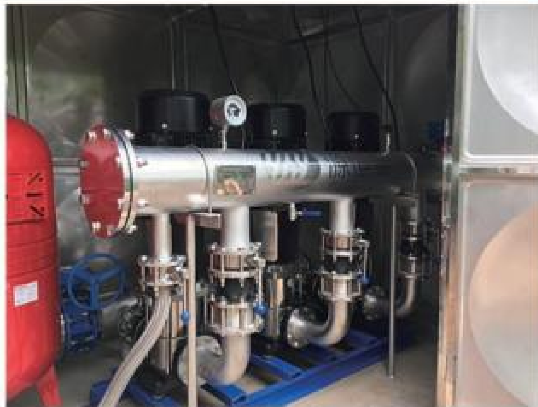
水箱内变频供水设备
