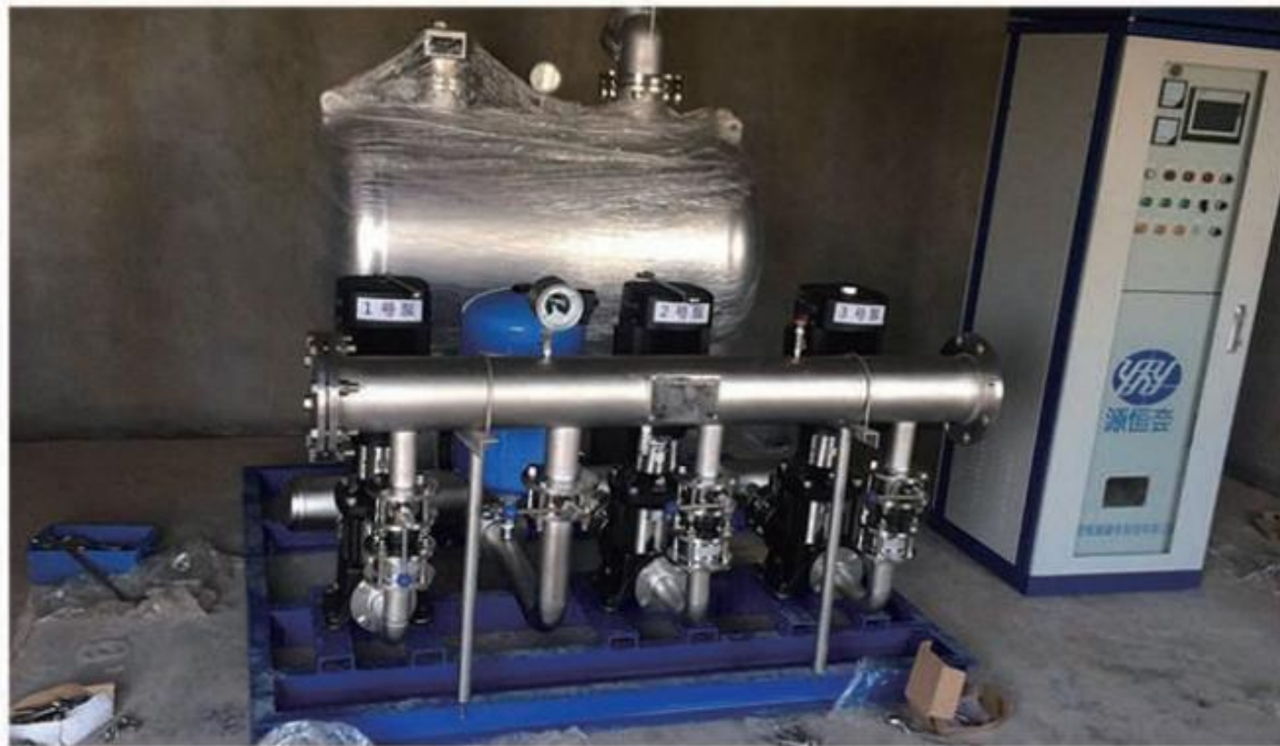
无负压供水设备
